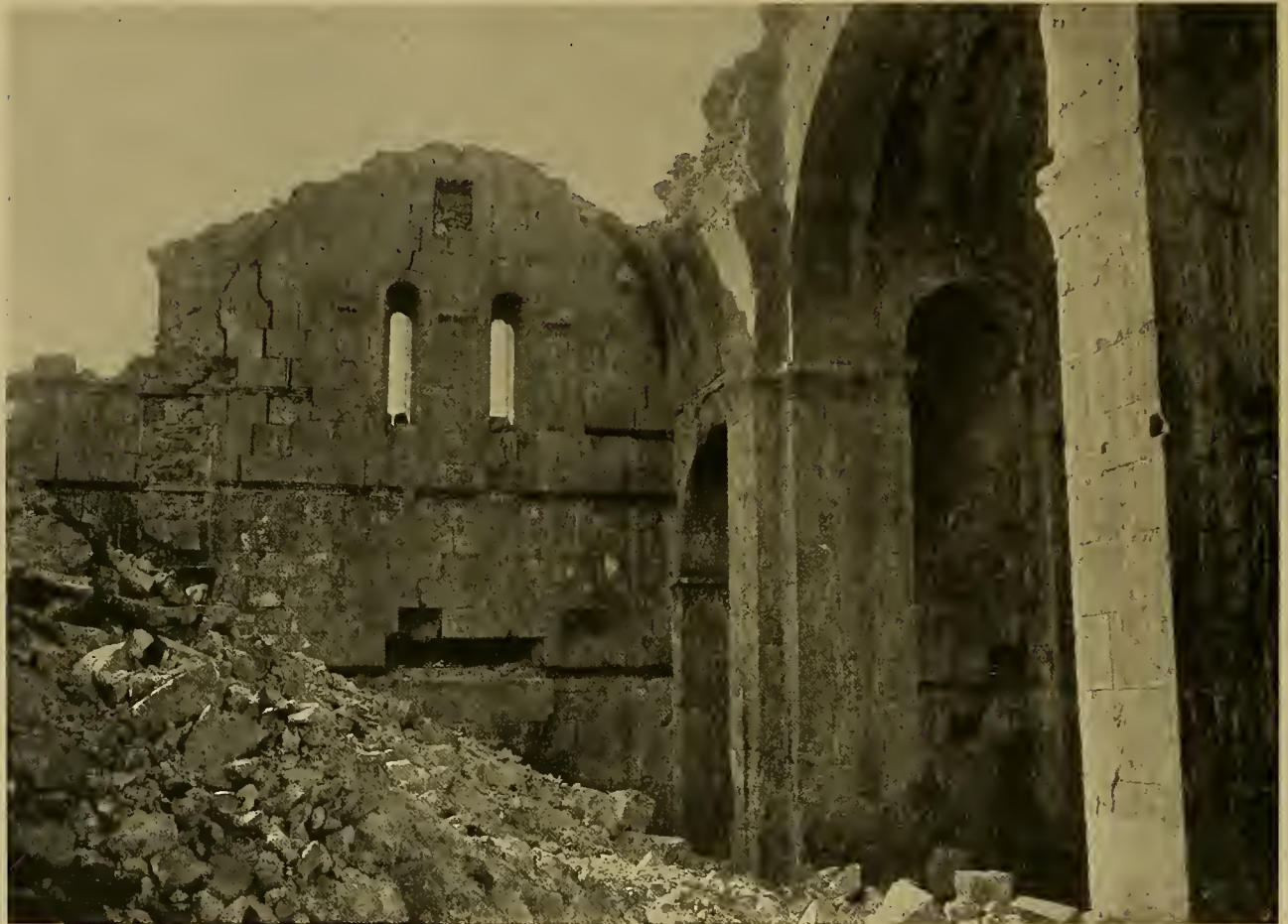
Abb. 250. Tekor, Sergiuskirche, Inneres: Die samt der Kuppel eingestürzten Gewölbe. Eingangsseite.
